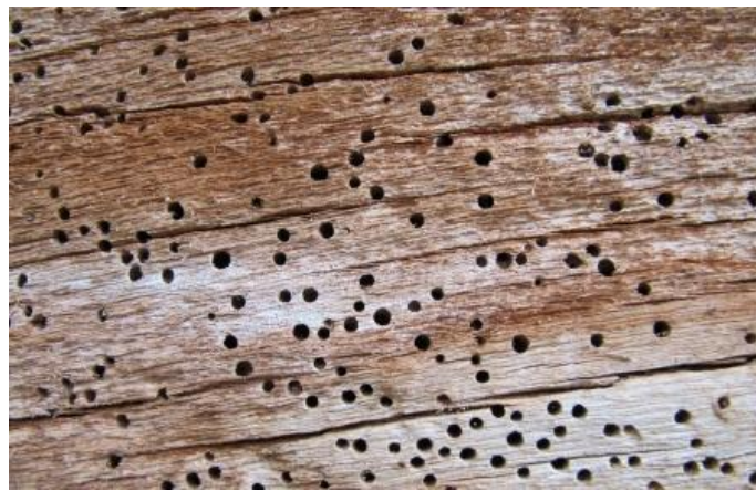
Figura 13. Madera afectada por carcoma. Fuente: https://lamadera.net/
