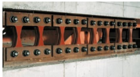
Figura 3.9. Disipador tipo HDS de la empresa Kajima Corporation instalado en muro de hormigón.
