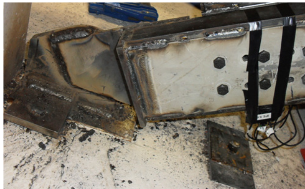
Figura 3.14. Detalle de la fijación soldada del disipador WPD a la chapa de sujeción entre los nudos viga-pilar en la estructura principal del edificio.
