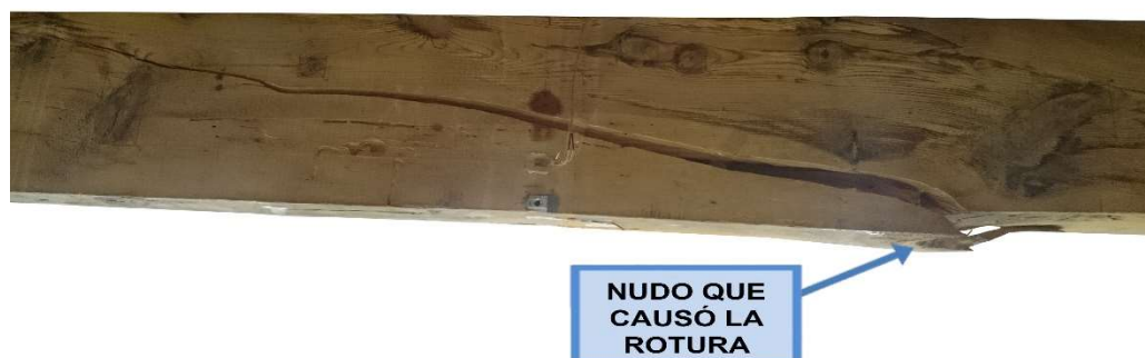
Figura 6.33 Rotura por tracción y cortante de la viga NR-1.
