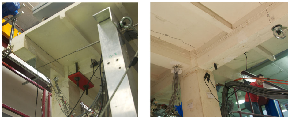
Figura 5.83: Unión viga-columna después de la simulación C100. Izqda.: unión exterior C3. Dcha.: unión interior C4.
