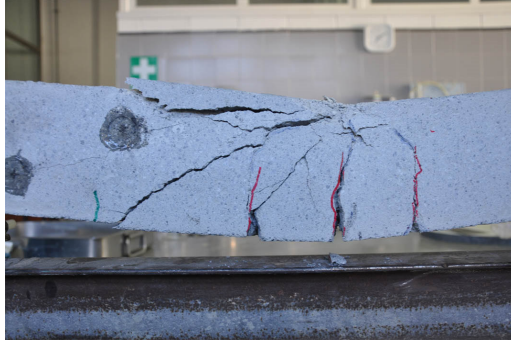
Figura 5.60: Estado de la viga sin muesca tras el ciclo 7. Estado final de la viga.
