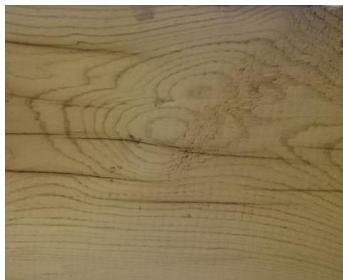
Figura 2.11. Fotografía de una viga de madera con cambios en la orientación de la fibra.
