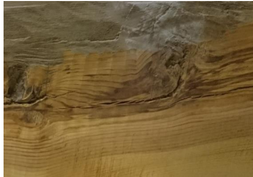
Figura 2.12. Fotografía de una viga de madera afectada por pudrición.
