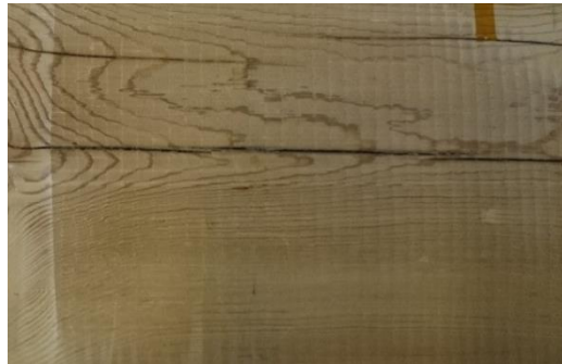
Figura 2.10. Fotografía de fendas en una viga de madera.
