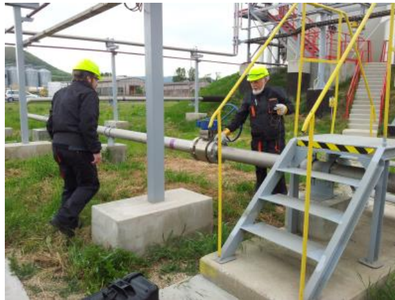
Figura 2.4. Aplicación del método de emisión acústica en una tubería.
