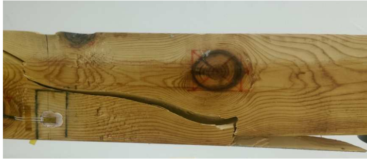
Figura 4.22. Rotura de la viga LR-S-P-3.
