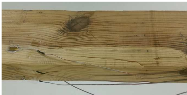
Figura 4.13. Rotura de la viga NR-4.
