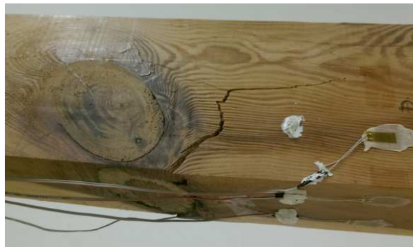
Figura 4.7. Rotura de la viga NR-1.
