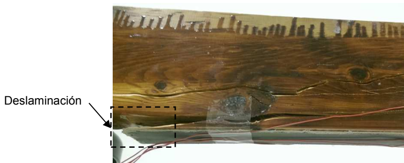
Figura 4.16. Rotura de la viga LR-S-P-1.
