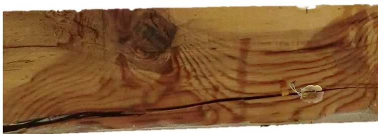
Figura 4.34. Rotura de la viga LR-S-F-3.
