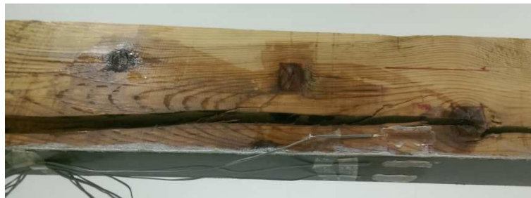
Figura 4.28. Rotura de la viga LR-S-F-1.
