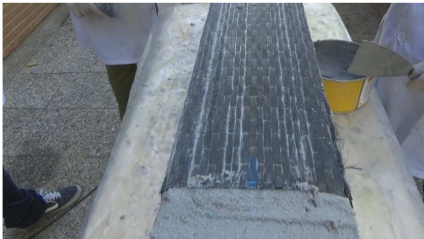
Figura 2.31. Colocación de tejido unidireccional de SIKA S.A.U sobre una de las vigas.
