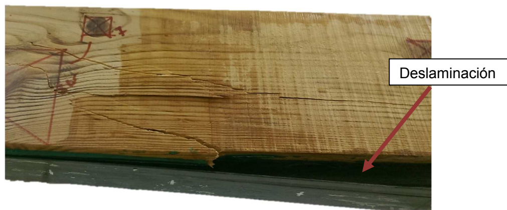
Figura 1.2. Deslaminación sufrida entre una viga de madera y un refuerzo de CFRP.
